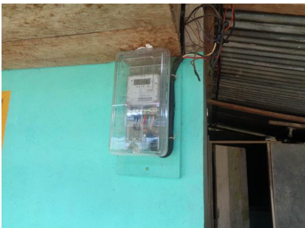
Fotografía 6.3-93: Recinto San Pablo de La Plata – Medidor Eléctrico. Fecha: 31-08-2021
