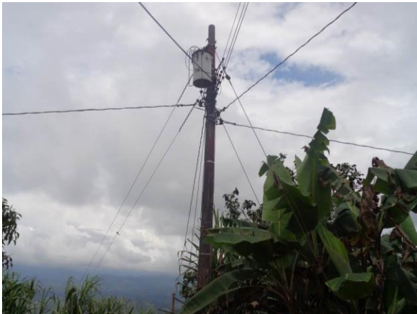
Fotografía 6.3-89: Recinto San Pablo de La Plata – Transformador de la Red Pública Eléctrica. Fecha: 30-08-2021
