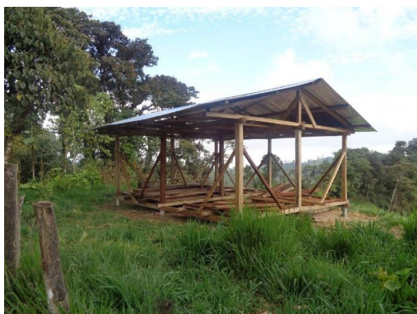
Fotografía 10.9-7: Recinto San Pablo de La Plata– Construcción de vivienda de madera. Fecha: 31-08-2021
