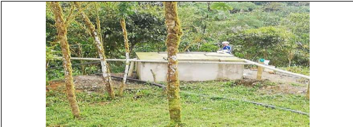
Fotografía 1.37. Pozo séptico, Concesión minera Leliatere
