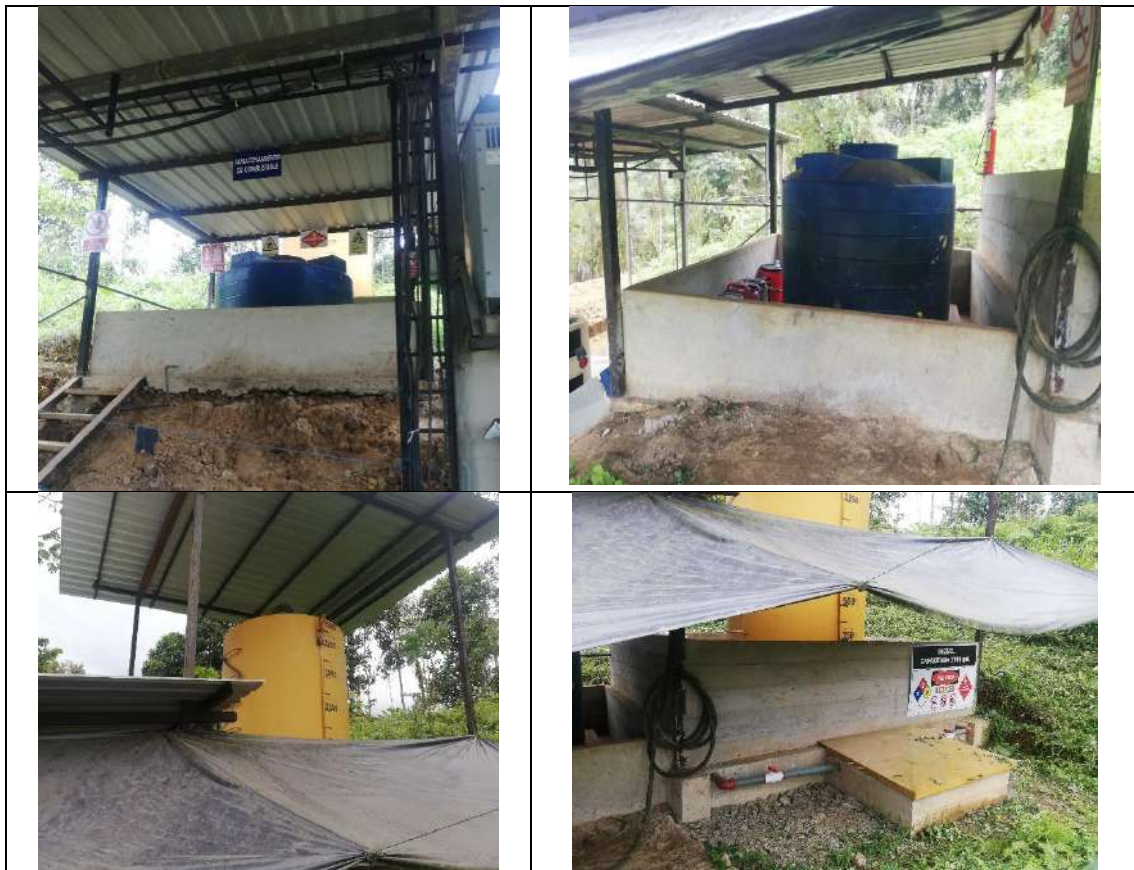
Fotografía 1.35. Almacenamiento de combustible, Concesión minera Leliatere
