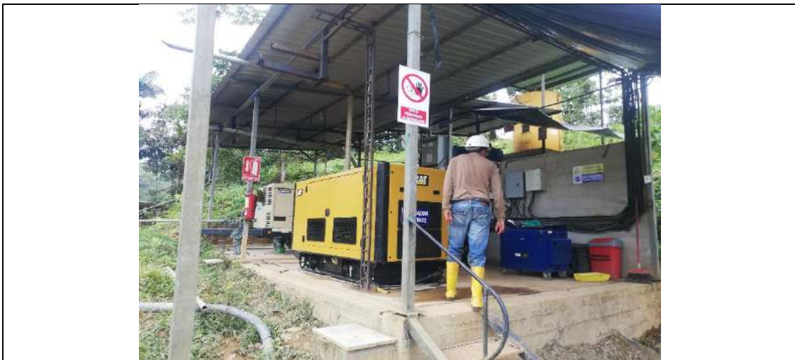
Fotografía 1.34. Generadores y compresores, Concesión minera Leliatere
